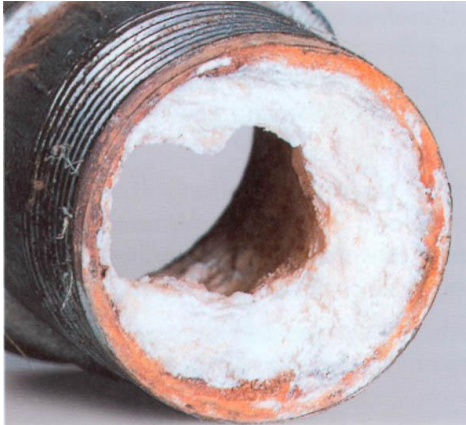
Mineralische Ablagerungen (Wasser- oder Kesselstein)
