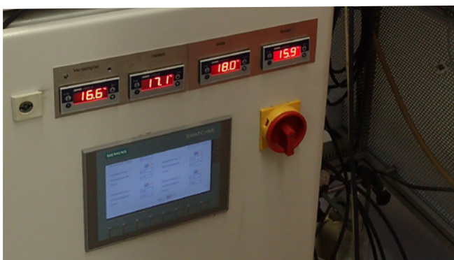
Abbildung 3: Zentrale Steuereinheit für die Precursor-dosierung an der CVD 2
