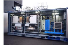
In Duisburg wurde der Kompressor in die Infrastruktur eines Forschungsinstituts integriert Quelle: Mehrer Compression GmbH
